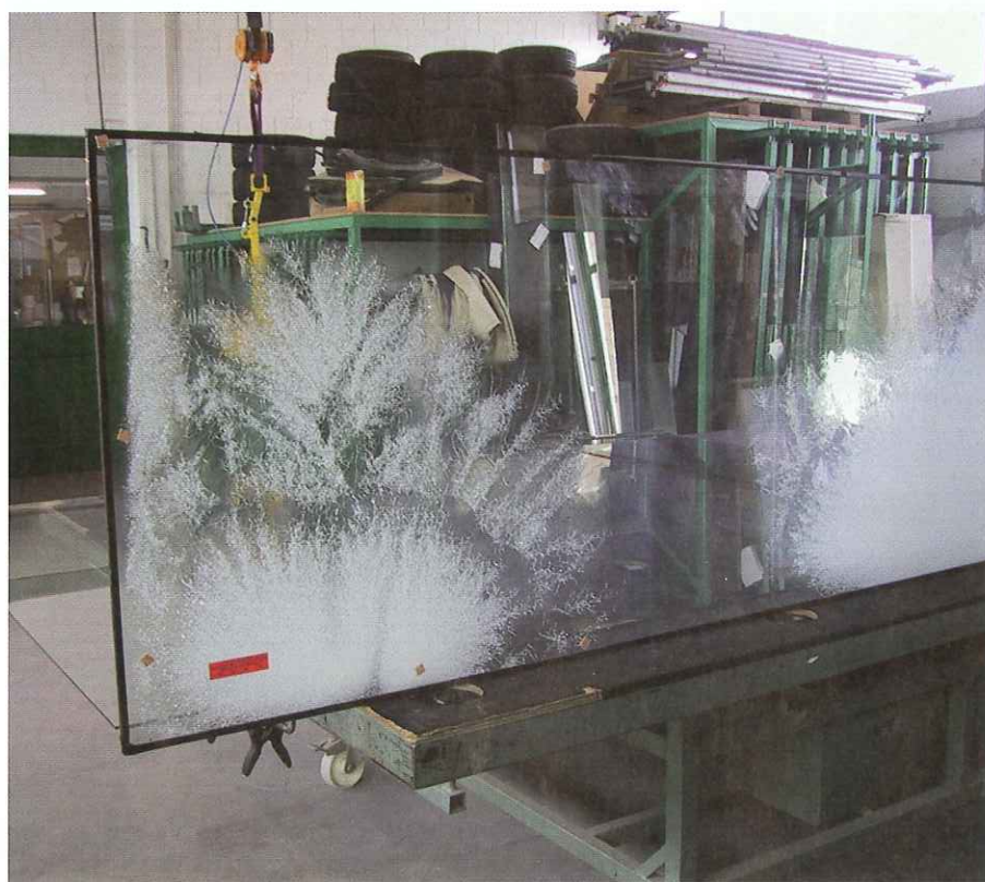
De laag in brandwerend glas kan opschuimen door weersinvloeden.
